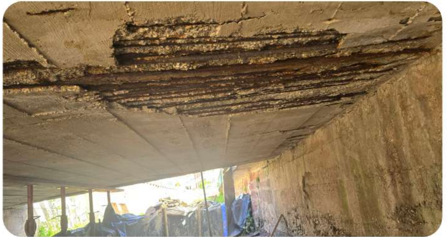
Pont rue de la Rivière : vue explicite sur la dégradation du dessous du tablier
