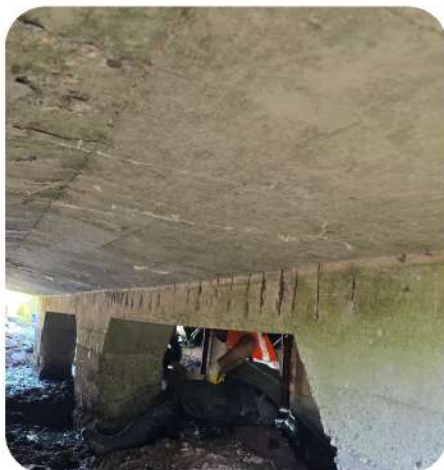
Pont salle des fêtes : vue sur la dégradation avancée du dessous du pont avec l'armature apparente
